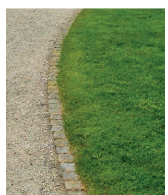
Water doorlatende verharding
